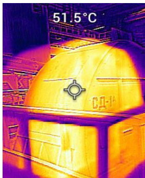
1-р зураг. МШ1-ийн СДМЗ 2-21-91-40 УХЛ4 хөдөлгүүрийн халалт
