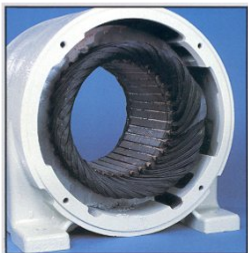
Хэт ачаалал авч шатсан байдал
