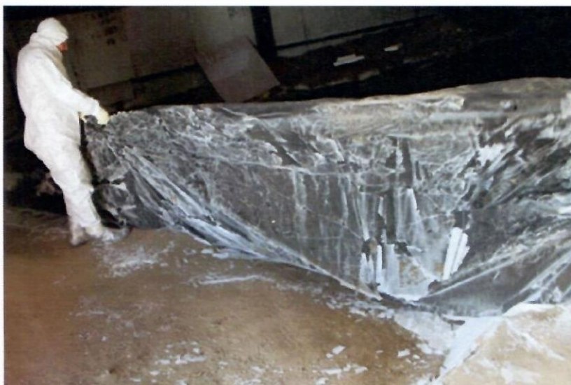
Зураг 1. Дулаалгын хучлагыг авахад мөстөлт, цан үүссэн байдал
